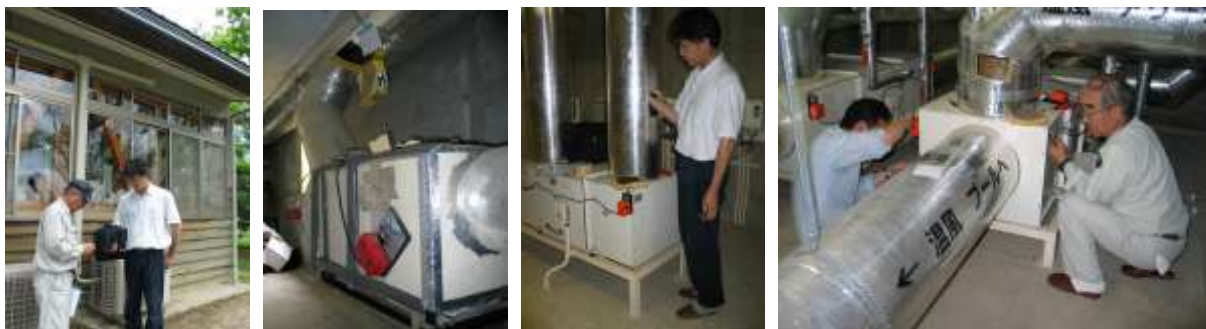
写真 1～4. 二本松市の施設における放射線量調査 屋外・設備スペース
